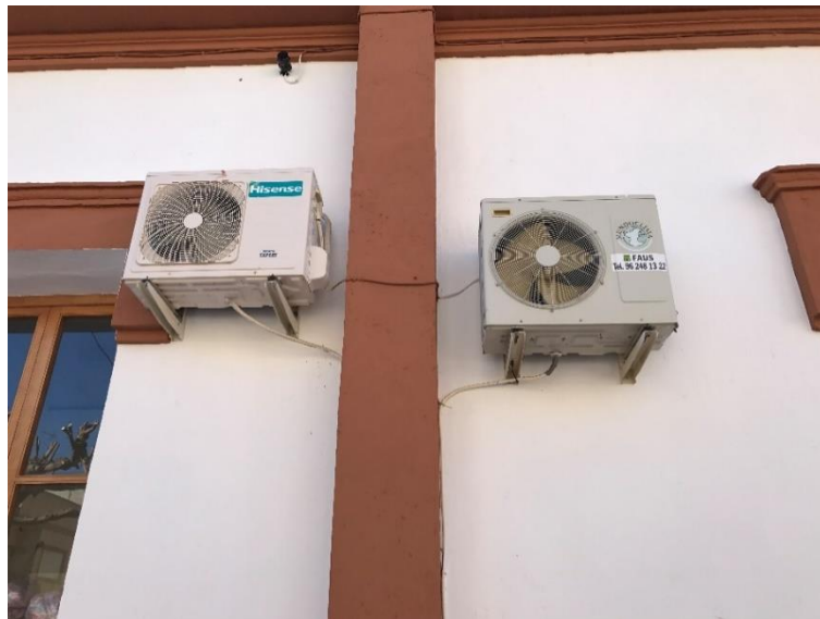
Il·lustració 5: Unitats exteriors Edificio Infantil
