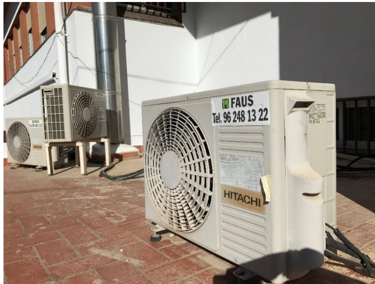
Il·lustració 4: Unitats exteriors Edificio Principal
