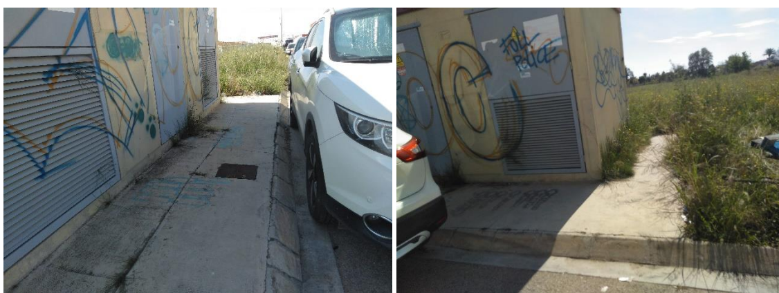
Foto 26. Centro de transformación de energía eléctrica situado al oeste de la actuación, en la calle Bollene.
