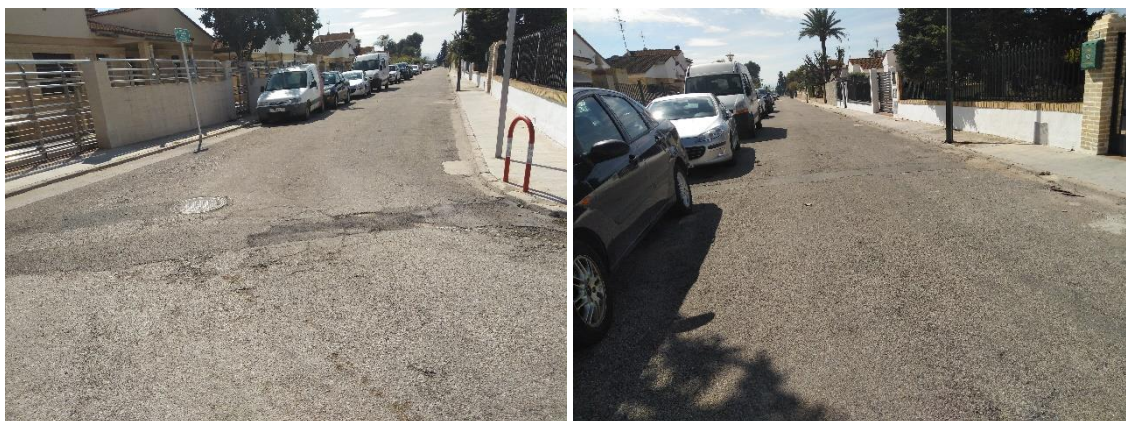
Foto 30. Estado actual de vial ortogonal a la actuación situado en la urbanización Ismael Tomás.
