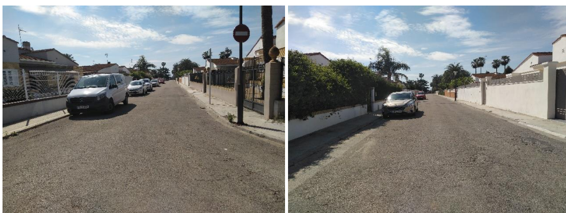
Foto 29. Estado actual de vial ortogonal a la actuación situado en la urbanización Ismael Tomás.
