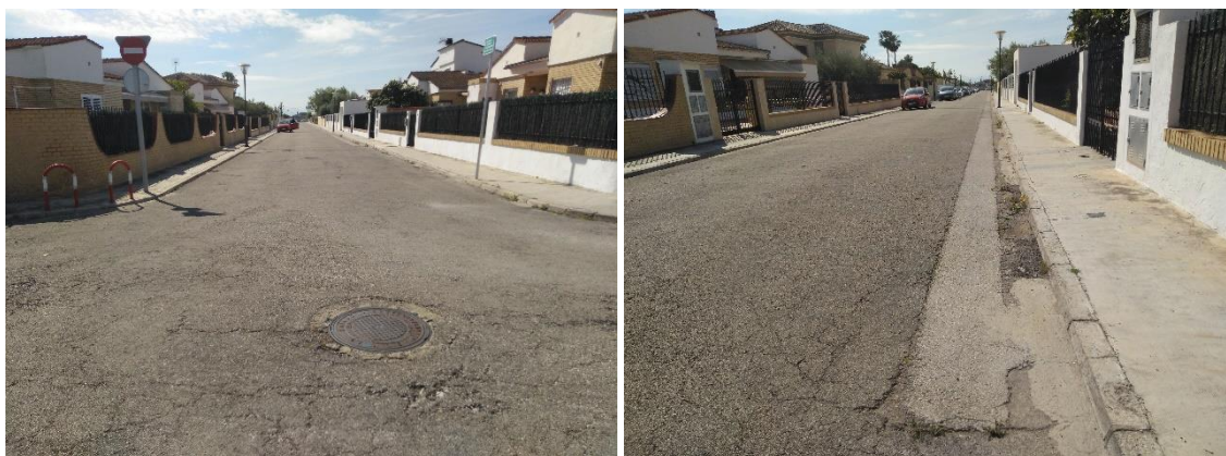
Foto 28. Estado actual de vial ortogonal a la actuación situado en la urbanización Ismael Tomás.
